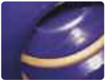
Defekte Dichtung in Glasschichttank
