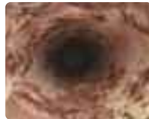
Kalkablagerungen an der Rohrwand
