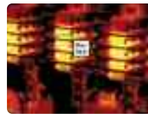
Trennschalter bei 75°C
