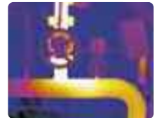
Thermografische Aufnahme einer defekten Absperrvorrichtung
