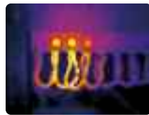
Leitung mit hoher Temperatur
