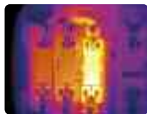
Stark erhitze Sicherung
