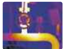
Thermografische Aufnahme einer defekten Absperrvorrichtung
