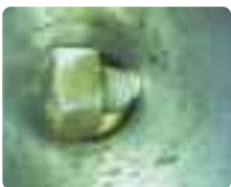
Schraube in einer Rohrleitung
