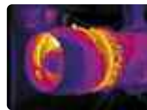
Thermografische Aufnahme einer Turbine
