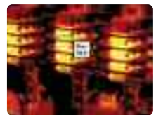
Trennschalter bei 75°C
